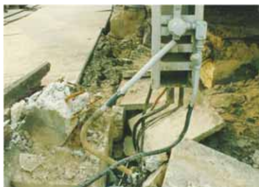
図 4 地盤変状の影響を受けた側溝中のケーブルの損傷
