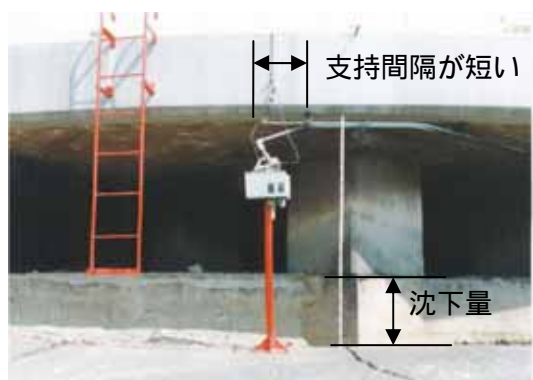
図 2 漏えい検知器の沈下による導管損傷
