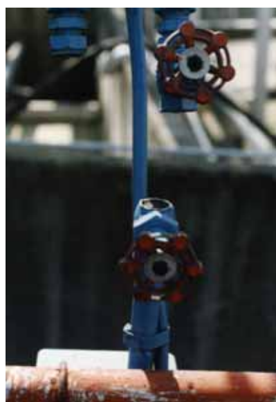
図 3 周辺構造物との干渉により配管破損
