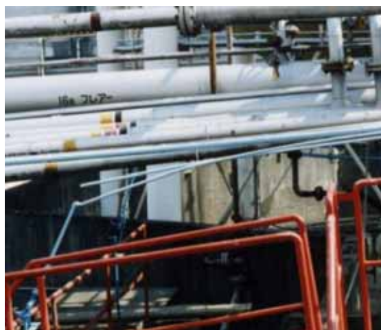
図 1 配管ラックの移動による配管破損
