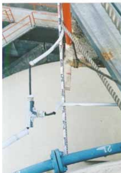
図 5 コンジットの損傷
