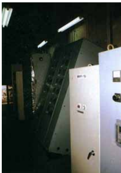
図 6 配電盤の転倒
