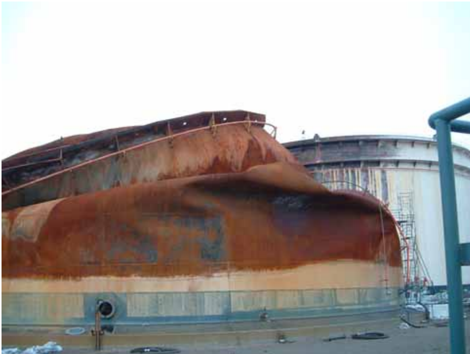
図1 平成 15 年十勝沖地震で発災し崩壊した 30,000kl ナフサタンク
